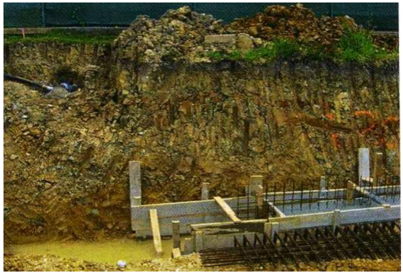
Acometida de agua en la obra
